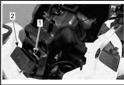
1. Caja de fusibles delantera 2. Tapa de la caja de fusibles delantera
