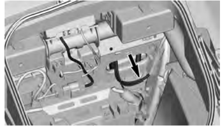
DC12 - CIRCUITO DELANTERO PARA ACCESORIOS DEL CLIENTE - TRAS EL COMPARTIMENTO DE ALMACENAMIENTO TRASERO
