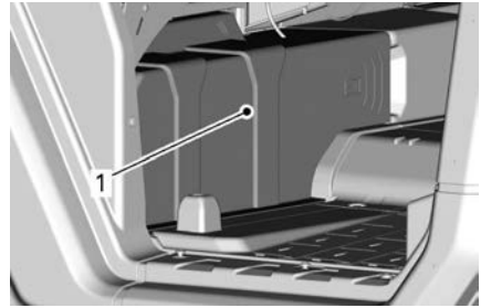
1. Крышка аккумуляторной батареи
