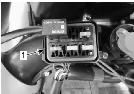
TYPEBILDE – DEKSEL PÅ SIKRINGSBOKS TATT AV
