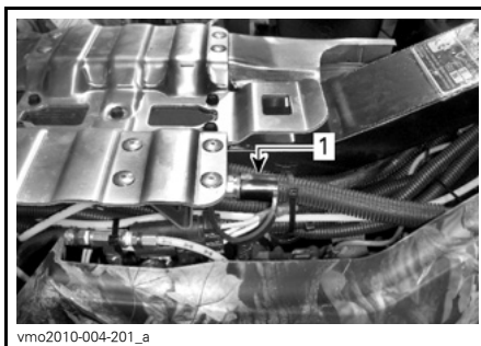
1. Conexão do compressor
