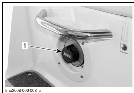
1. Interruptor de desconexión de la batería principal
