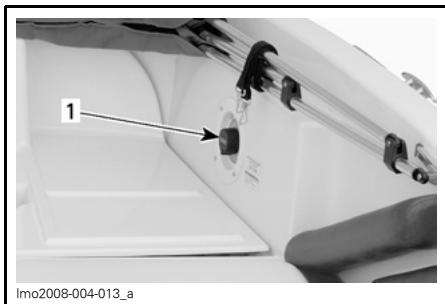
1. Interruptor de desconexión de la batería principal
