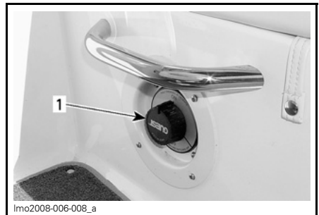
1. Interruptor de desconexión de la batería principal
