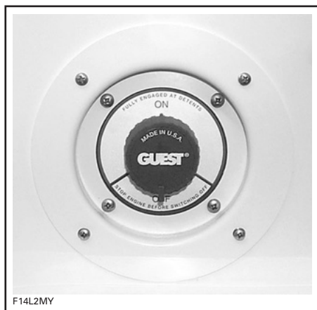
SITUAZIONE TIPICA — INTERRUETTORE BATTERIA PRINCIPALE
