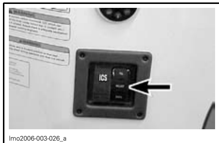
MANDOS DEL DEPÓSITO DE LASTRE
