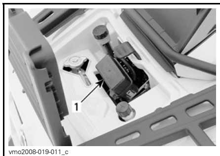
1. Caixa dos fusíveis da frente
