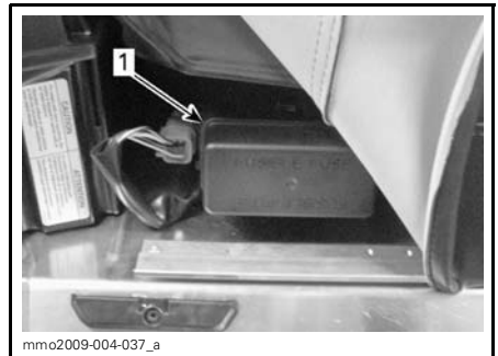
1. Boîte à fusibles
