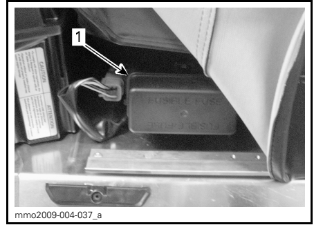
1. Boîte à fusibles
