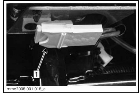
MOTORRUM — UNDER KONSOLEN 1. Säkringshållare
