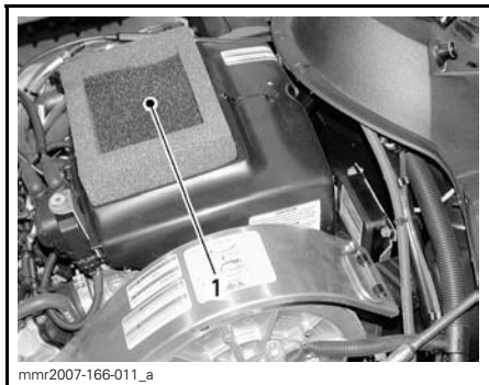
1. Luftfiltret installerat ovanpå insugningsdämparen
