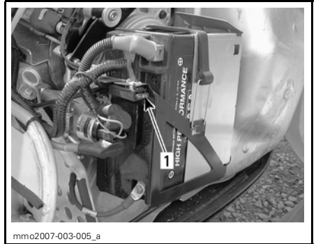
1. Fusible du circuit de charge
