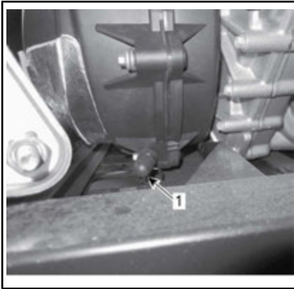
1. Drainage de la boîte de vitesses CVT
