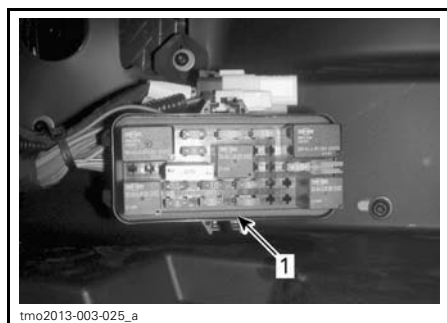
1. Boîte à fusibles principale
