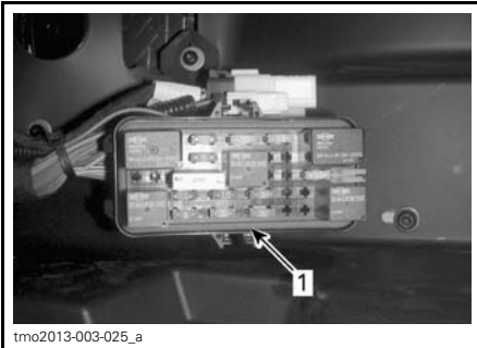
1. Boîte à fusibles principale
