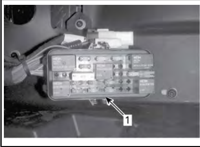
1. Scatola di fusibili principale
