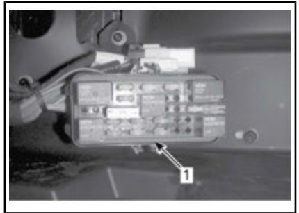
1. Caixa de fusíveis principal
