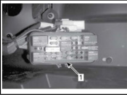
1. Scatola di fusibili principale
