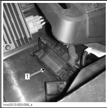
1. Boîte à fusibles auxiliaire
