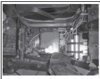
COMPRESSOR DA ACS
