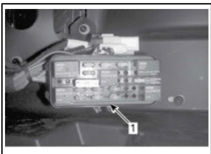
1. Caixa de fusíveis principal
