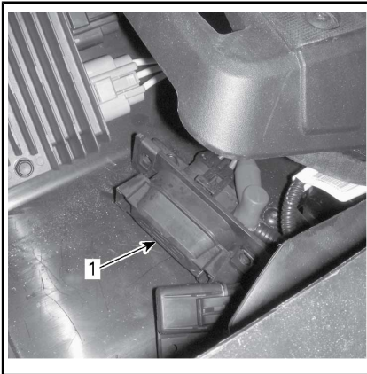
1. Caixa de fusíveis auxiliar
