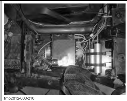
TYPIQUE - COMPRESSEUR ACS
