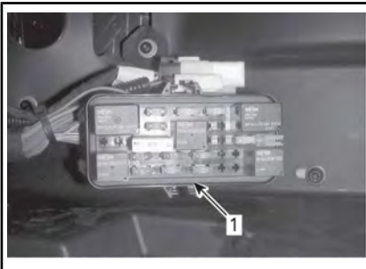
1. Scatola di fusibili principale
