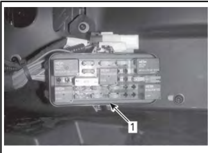
1. Caja de fusibles principal
