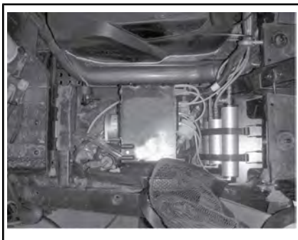
COMPRESOR DE ACS
