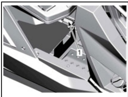
1. Caixa de fusíveis auxiliar
