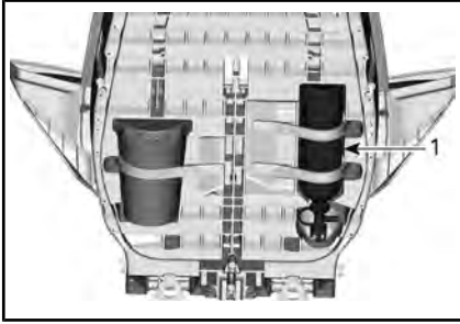
1. Extintor de incendios
