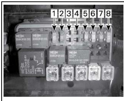
FUSIBILI - SCATOLA FUSIBILI SINISTRA
