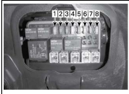
SICHERUNGEN - LINKER SICHERUNGSKASTEN
