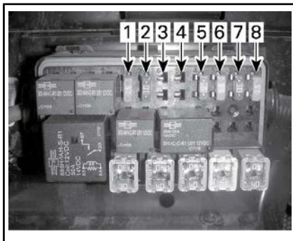
FUSÍVEIS - CAIXA DE FUSÍVEL ESQUERDA
