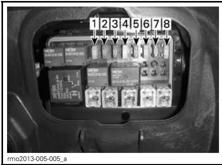
SICHERUNGEN - LINKER SICHERUNGSKASTEN
