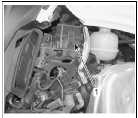
TYPEBILDE – HØYRE SIDE AV MOTORROM
