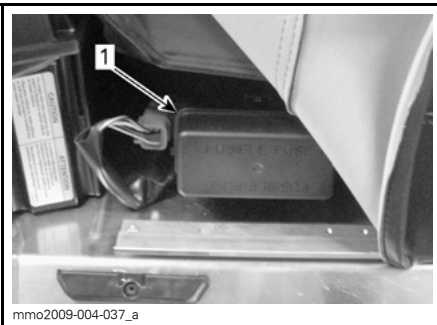
1. Boîte à fusibles
