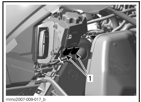
HØYRE SIDE AV MOTORROMMET
