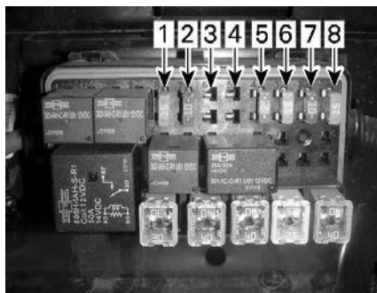
SIKRINGER – VENSTRE SIKRINGSBOKS
