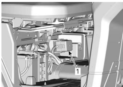
1. Boîte à fusibles secondaire arrière
