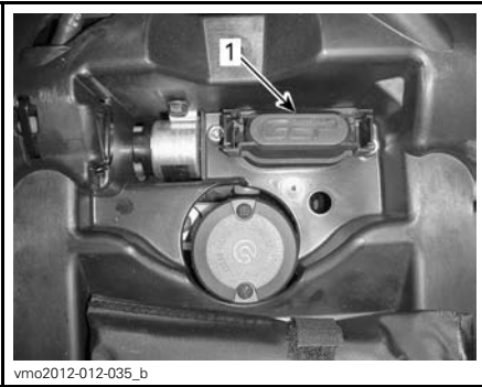
1. Lokk for sikringsholder bak
